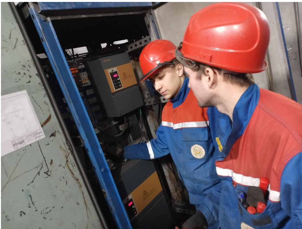
Самостоятельная ревизия электрооборудования
